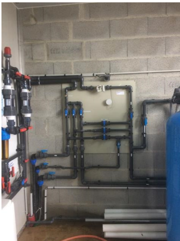
Figure 11 : Station de traitement de l'eau du forage 1/2
