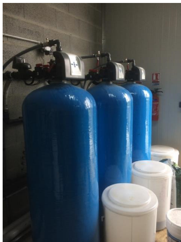
Figure 10 : Station de traitement de l'eau du forage 2/2
