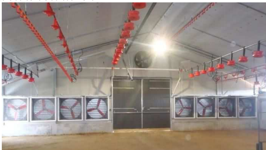
Figure 7 : Turbines sur le pignon Sud des bâtiments 2 et 3
