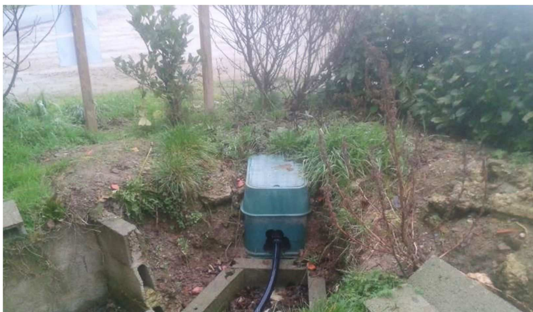
Vue 12 : Vue du forage
