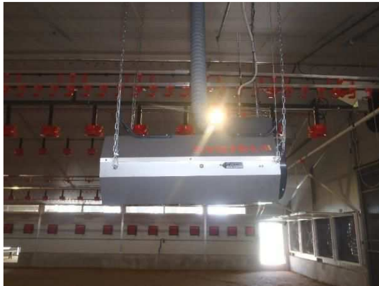
Figure 9 : Canon de chauffage dans les bâtiments 2 et 3
