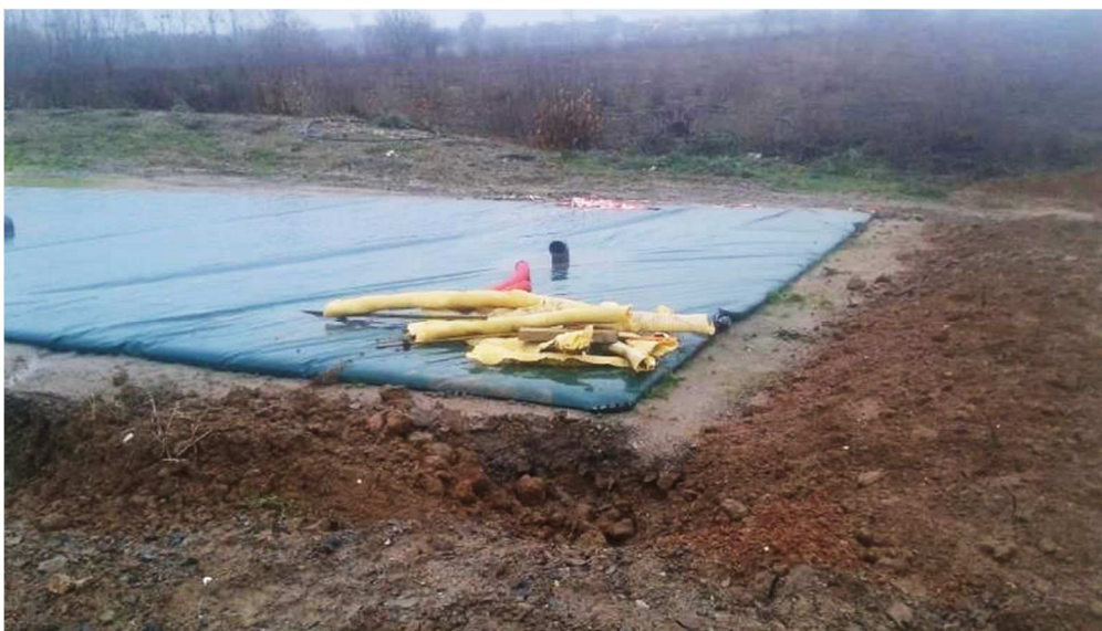
Vue 11 : Vue de la poche de stockage des eaux usées du bâtiment 1
